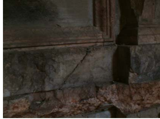
Fratture e fessurazioni
