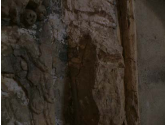
Fratture e fessurazioni, mancanze
