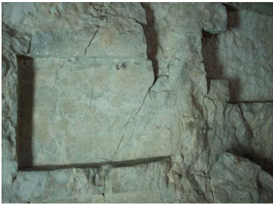
Fratture e fessurazioni
